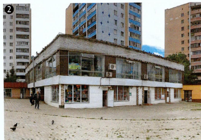
Неудовлетворительное состояние покрытий
